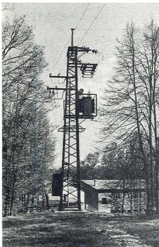
Ena izmed številnih jamborskih transformatorskih postaj
