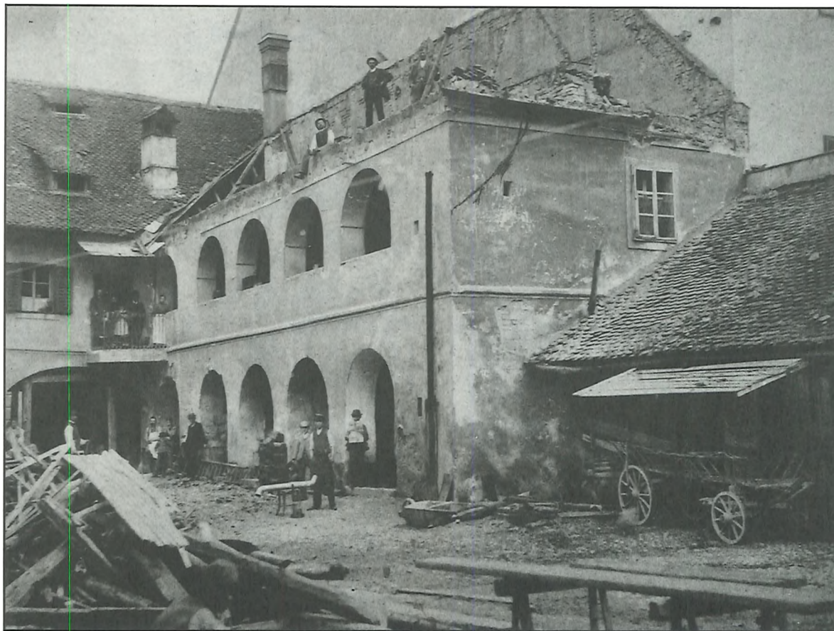
Od potresa prizadeta hiša na gradišču
